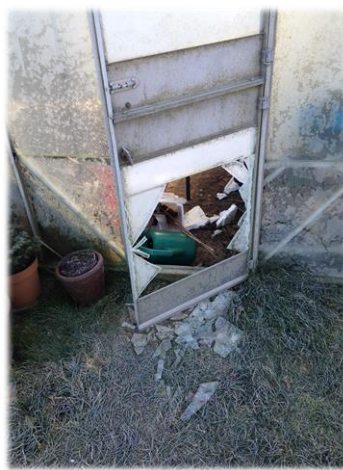
Ødelagt dør i Drivhus i have 12
