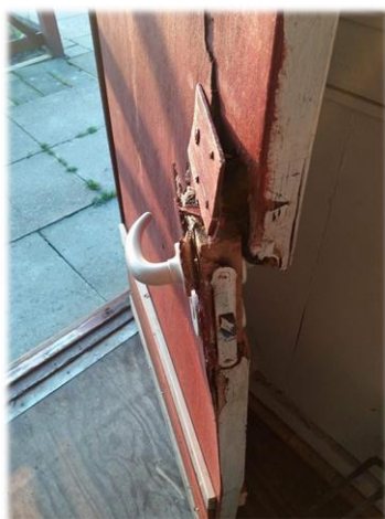
Ødelagt dør til skur i have 3
